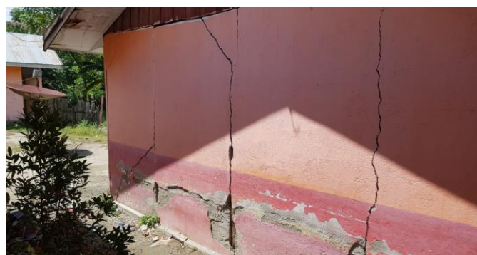
Tinjauan kerusakan SDN Poboya
