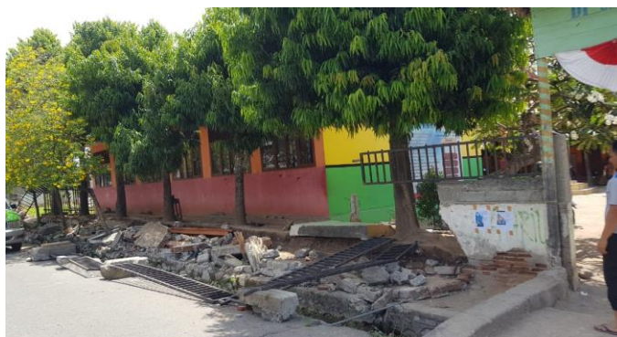
Tinjauan kerusakan SDN Poboya
